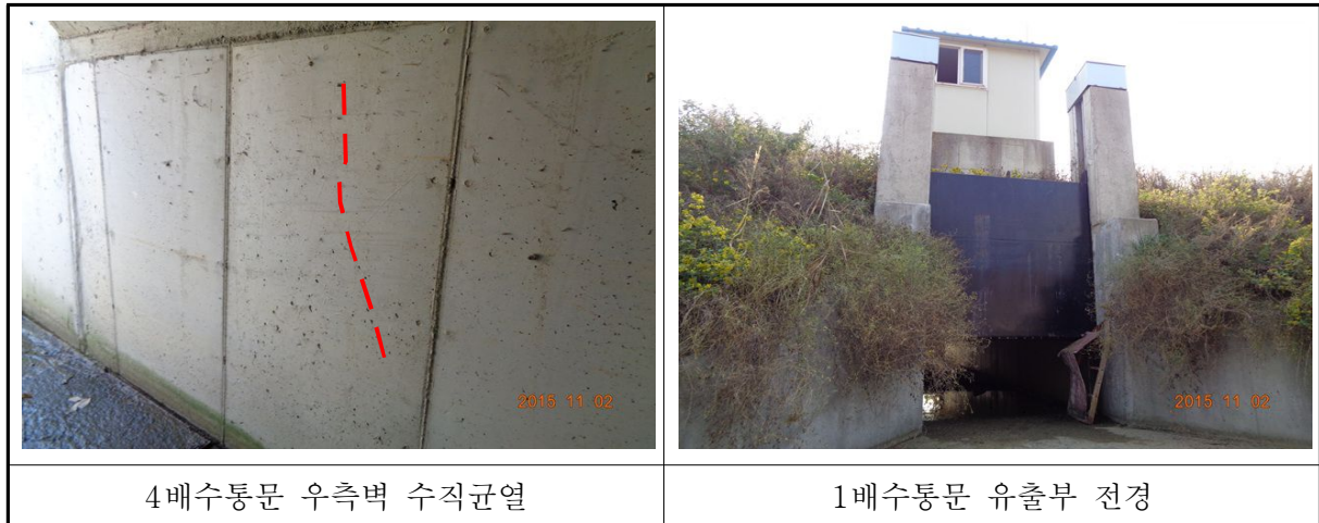
【사진 Ⅱ.1-4】 배수통관 현황
